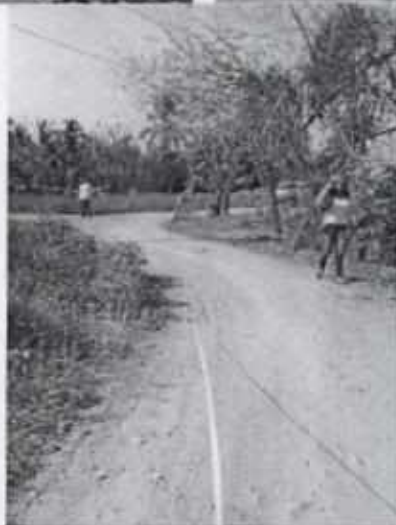
Fig 28, 29 y 30. Mejoramiento de vías con material seleccionado (Barrio Nueva Esperanza Sector Torrente Usuario)
