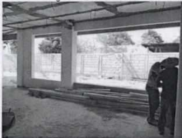
Fig 59. Cielo Raso no instalado.
