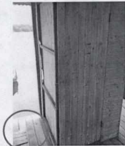
Fig 5. Se aprecia un solo baño instalado y la señal del sitio donde fue instalado el segundo baño.
